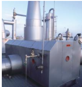
BDO 廢熱回收設備
